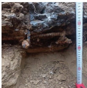
Рисунок – 2 – дефекты подошвы фундамента.
