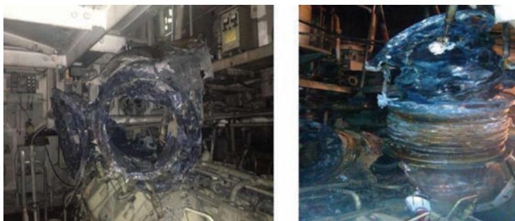
Рис. 1 - Разрушение газохода главного двигателя №3, сильфонного компенсатор и тепловой изоляции трубопровода
