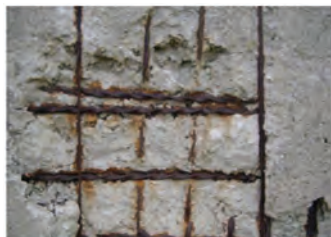
Карбонизация - это образование карбоната кальция внутри бетонной конструкции.
