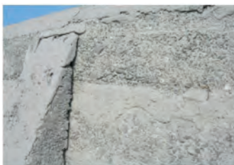
Эрозия и выветривание
