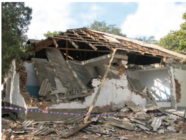
Рисунок 2 – Общий вид поврежденного здания в результате сейсмического события, произошедшего в Чеченской Республике в октябре 2008 года
