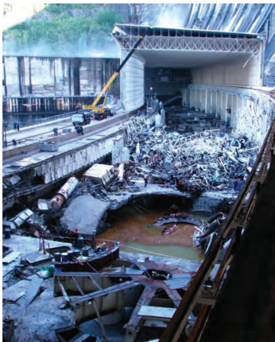
Рисунок 3 – Общий вид поврежденных машинного зала Саяно - Шушенской ГЭС в результате техногенной катастрофы, произошедшей в августе 2009 года в п. Черемушки
