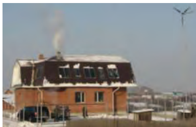
Рисунок 2 - Использование ФЭС для электроснабжения частного жилого дома в близ поселка Дрокино
